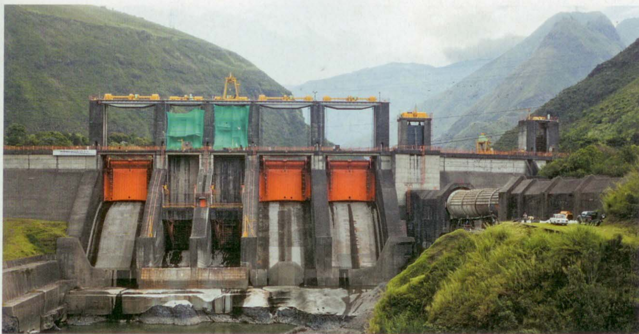
Centrali idroelettriche come quella di Agoyan, sul fiume Pastaza, la cui potenza è di 156 megawatt, talvolta in estate restano senz'acqua.
